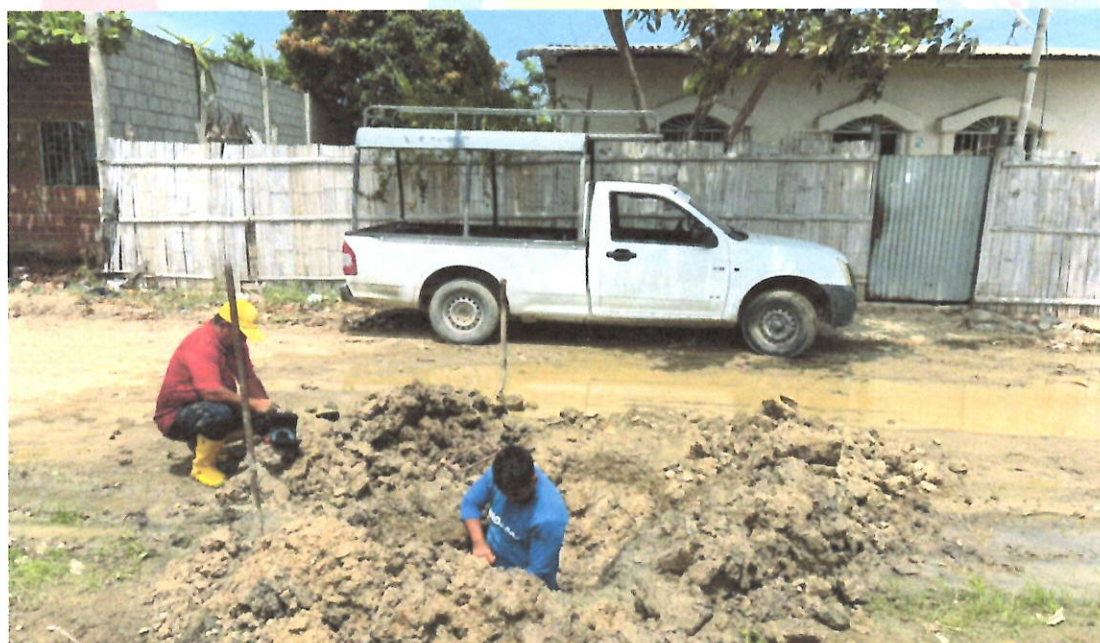
Ilustración 9. Atención de daños y fugas en tuberías en distintos sectores de los cantones Huaquillas.
